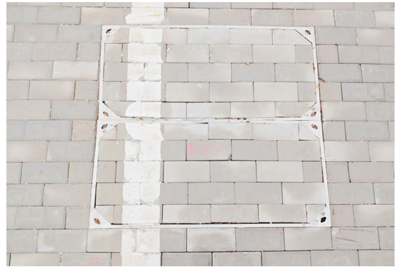
项目内燃气检修井
