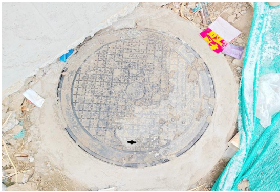
项目内下水检修井
