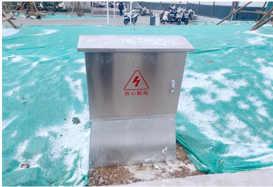
项目内配电箱
