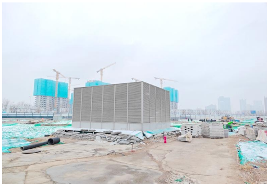
项目内地下通风口
